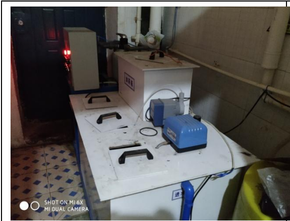
污水处理设施
