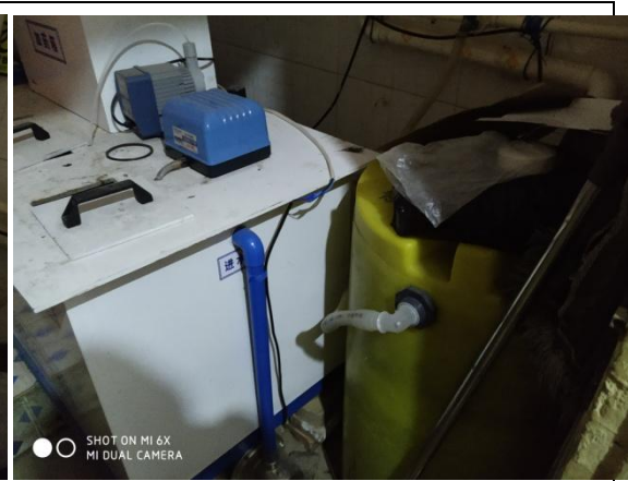
污水处理设施
